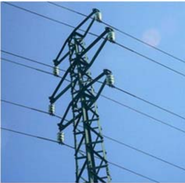
Fig. 1. Línea eléctrica de alta tensión.
