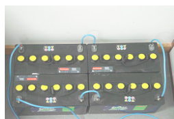
Figura 16 – Banco de baterias
